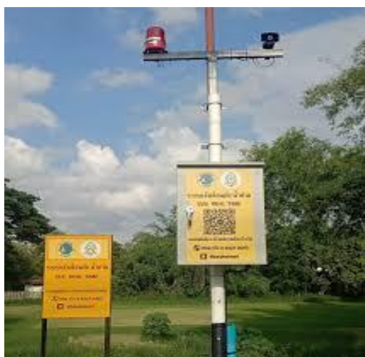
ภาพที่ 4.121 ระบบแจ้งเตือนภัยระดับน้ำ
